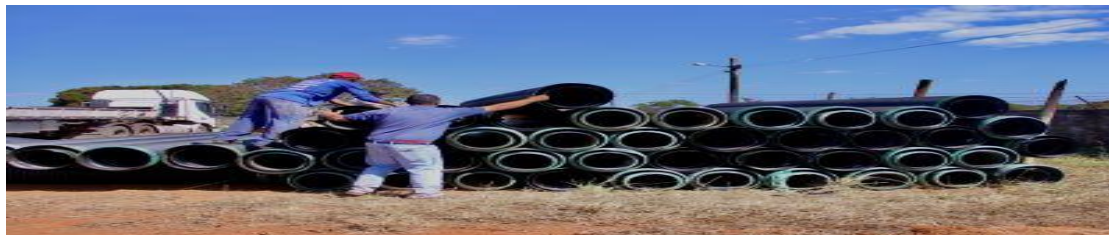
Figura 3. Tubos de PEAD utilizados para tubulação de canais de irrigação
